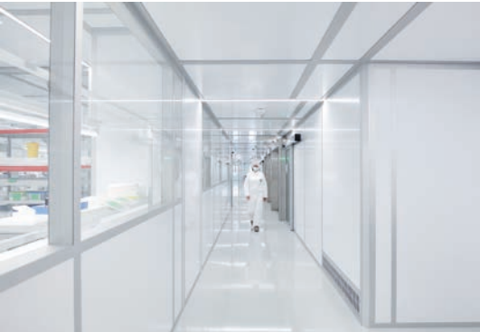
▲ Ein Flur innerhalb des Reinraums verbindet die Personalschleusen mit den Arbeitsräumen.
