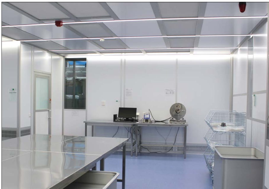
Reinraumsystem CleanCell4.0 der ISO-Reinraumklasse 5. Die dimmbare LED Beleuchtung sorgt für ausgewogenes Licht im Bereich des Legetisches. (Bilder: Schilling Engineering)
